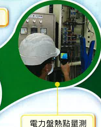
空調主機檢測
